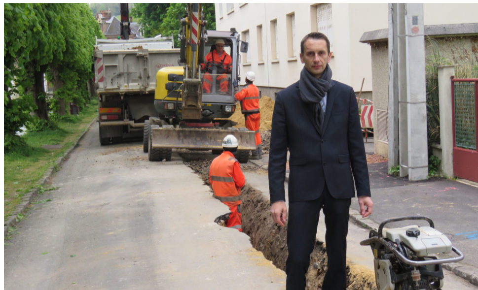
Le renouvellement des canalisations d'eau potable a débuté le long du boulevard de Verdun. Un chantier suivi de près par Léopold Dussart, conseiller municipal délégué en charge de l'eau et de l'assainissement.
